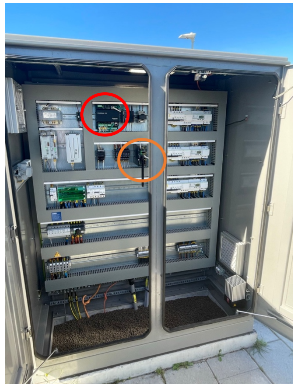
Figuur 1: Betreffende walstroomkast Dintelhaven
